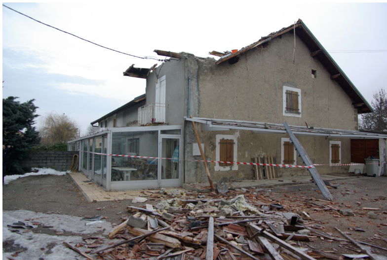
Figure 2 - Dommages sur la maison
